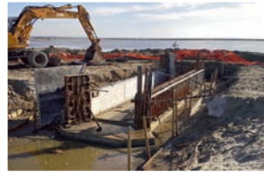
2 Nouvelle vanne d'entrée d'eau
